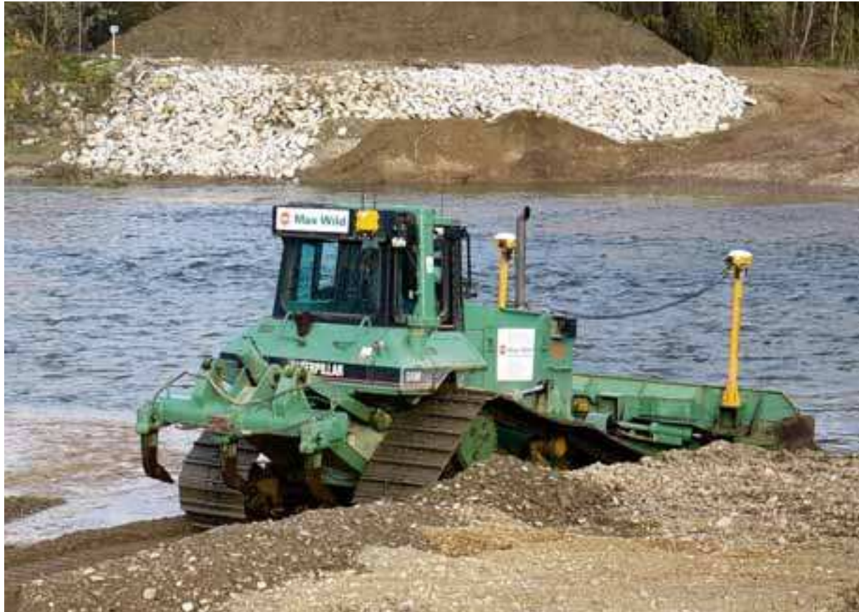
Durch die Renaturierung ist an der Iller bei Vöhringen eine Großbaustelle entstanden. Beispielsweise werden 35 000 Tonnen Flussbausteine angeliefert. Derzeit gehen die Arbeiten dank niedrigen Wasserstandes zügig voran. Foto: Michael Seefelder
