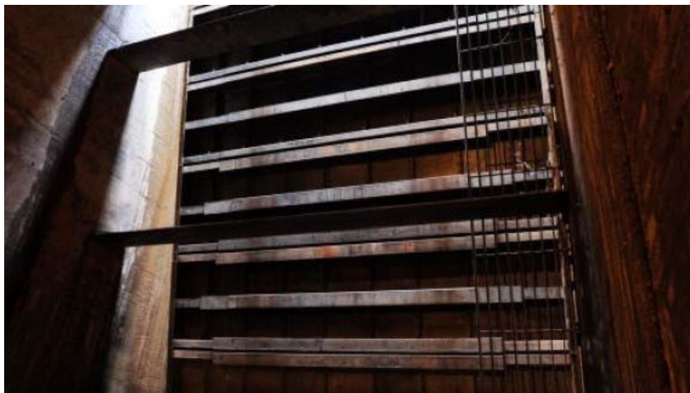
Wasserkraftwerk in Rain am Lech
